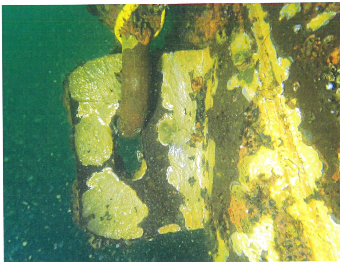
Puntone S6: corrosione sulla piastra ad occhio e sui cordoni di saldatura
