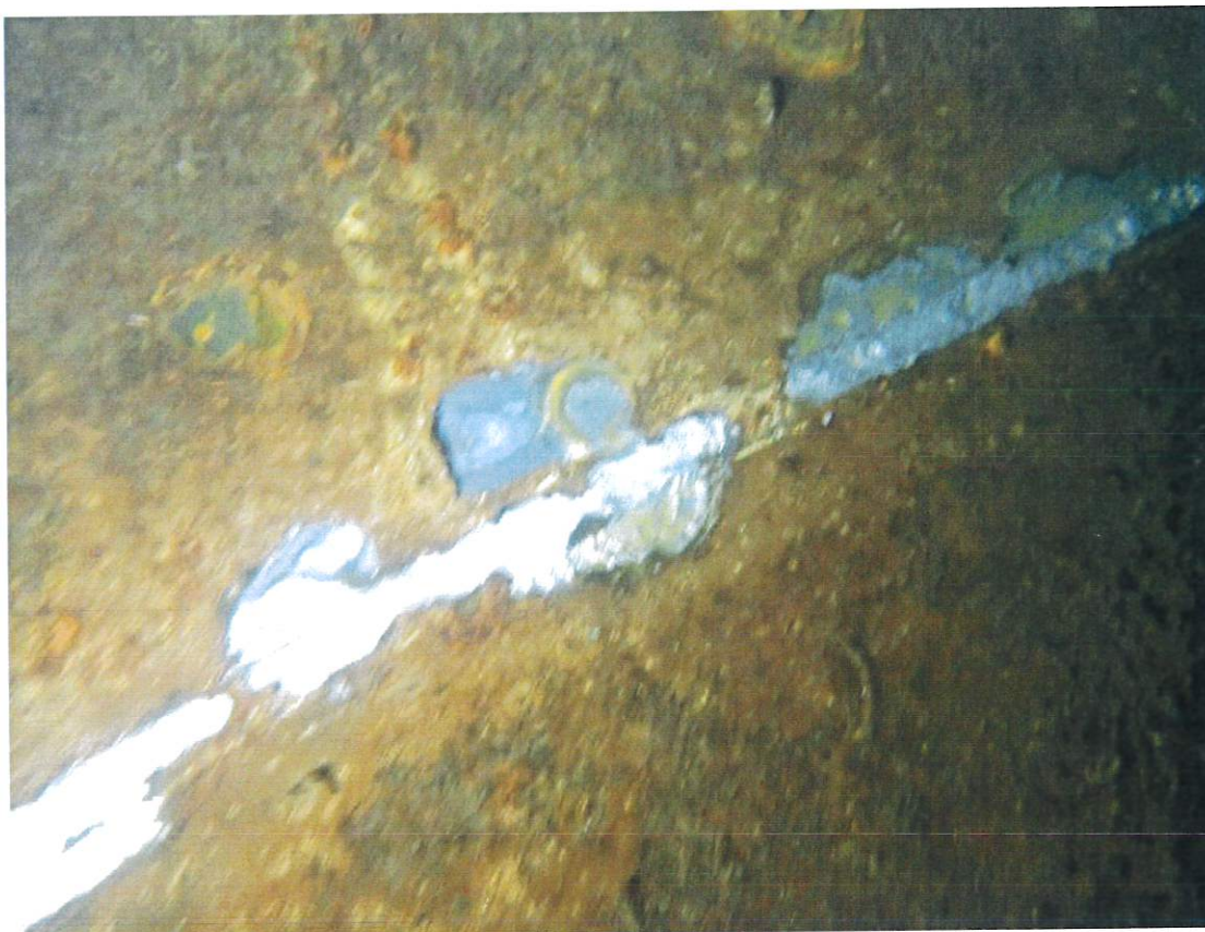
Puntone S3: saldatura corrosa sul puntone
