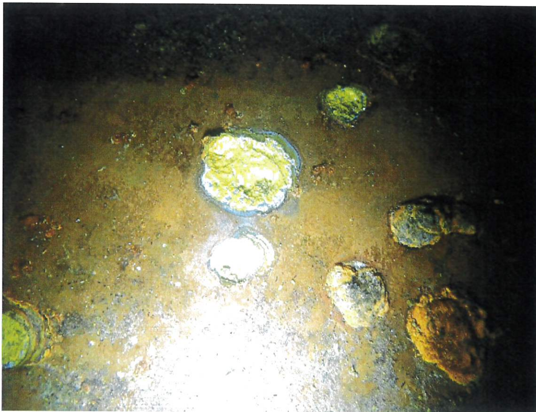
Puntone S4: corrosione sul puntone
