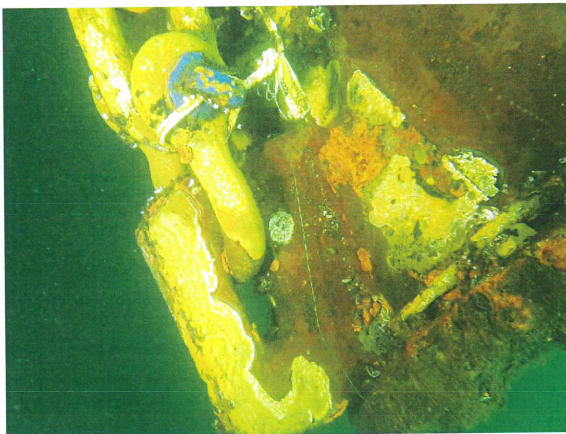
Puntone S5: corrosione sulla piastra ad occhio e sui cordoni di saldatura
