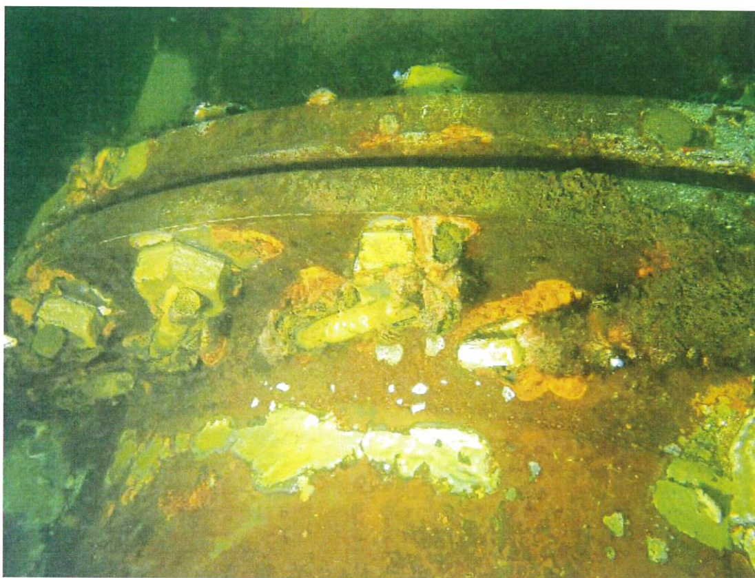
Puntone S5: corrosione sul giunto flangiato
