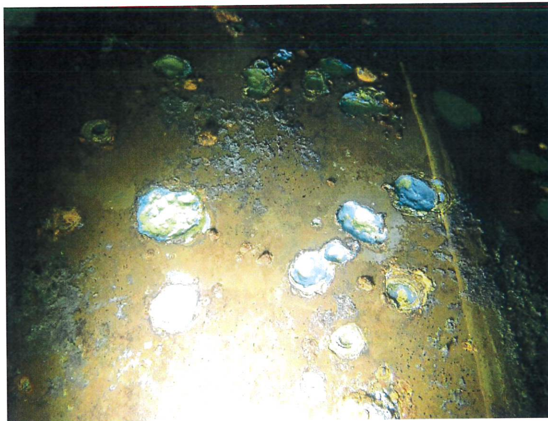
Puntone S5: corrosione sul puntone
