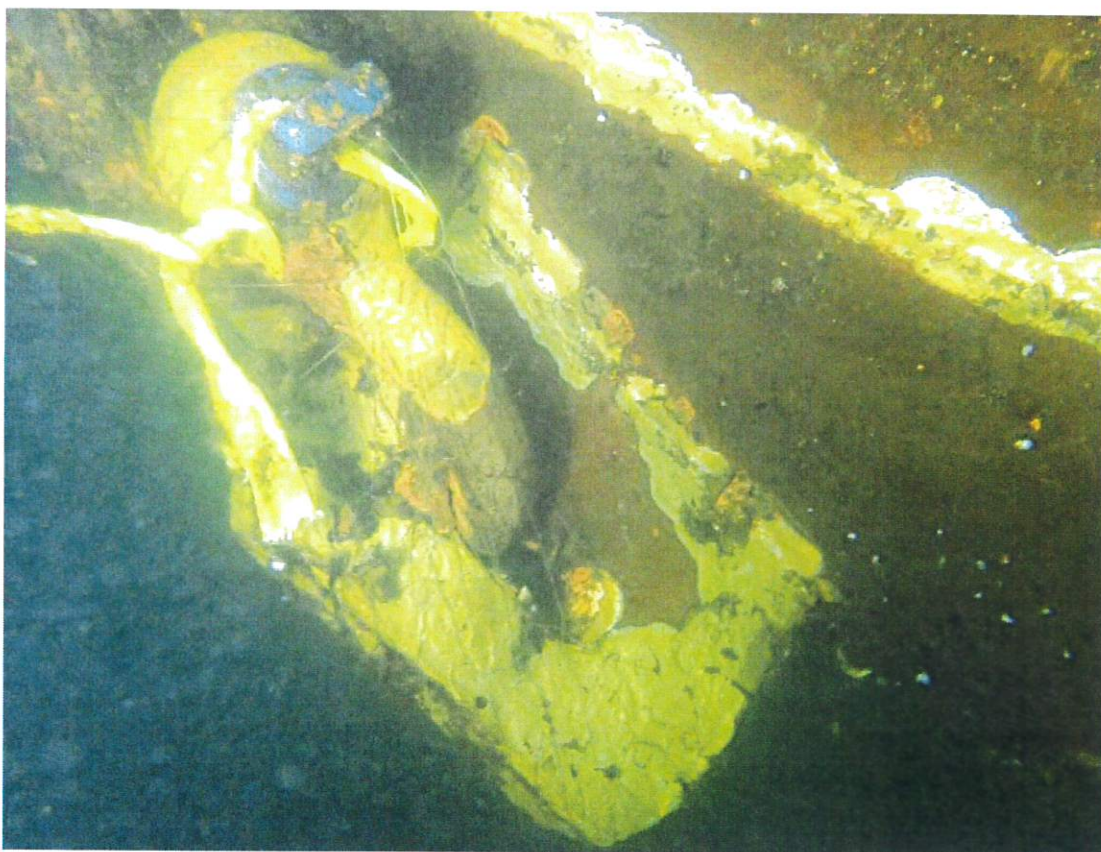
Puntone S4: corrosione sulla piastra ad occhiello e sui cordoni di saldatura
