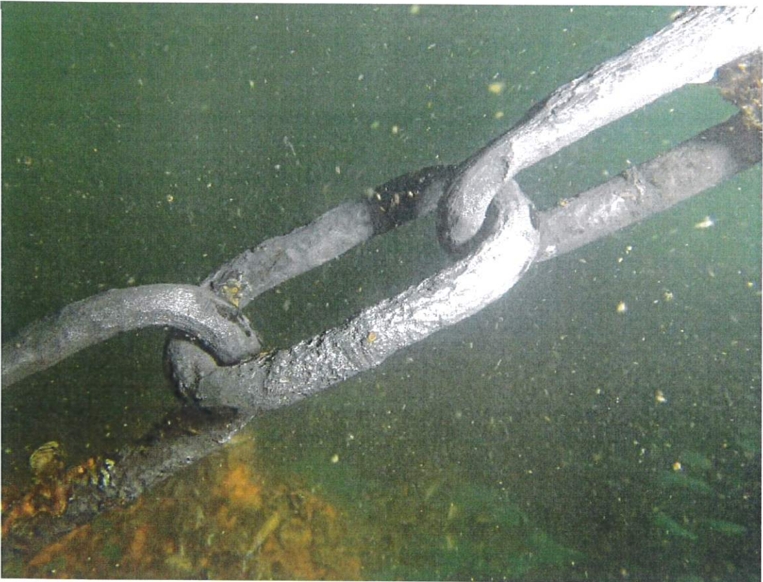
Catena K13: collegamento al molo, catena usurata
