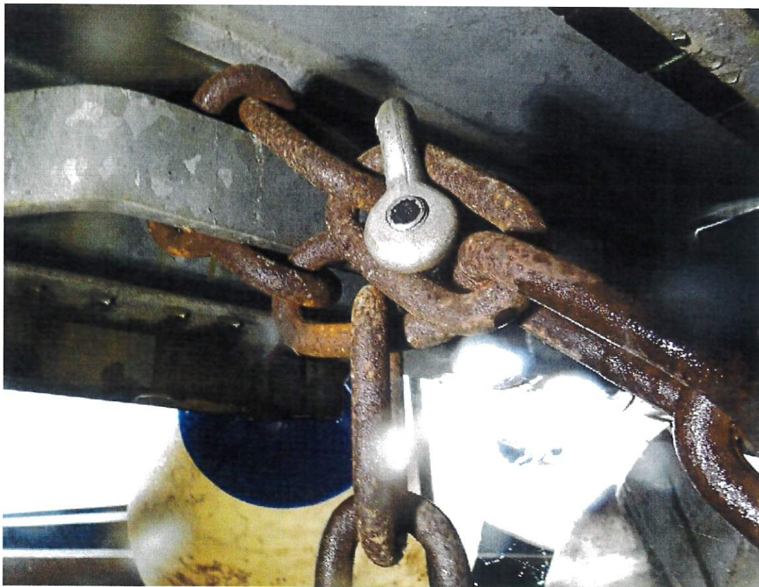
Catena K14: collegamento al pontile galleggiante
