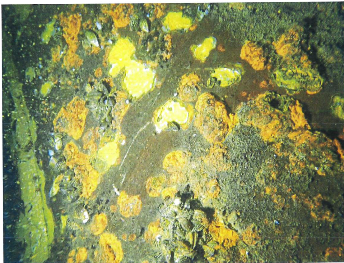
Puntone S6: corrosione sul puntone
