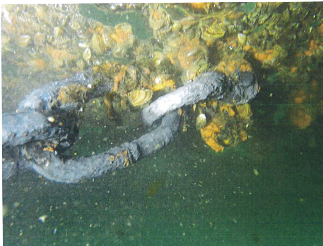
Catena K7: collegamento al molo, catena usurata
