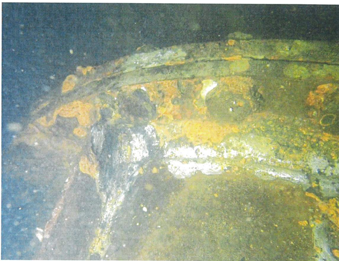
Puntone S3: corrosione sul giunto flangiato
