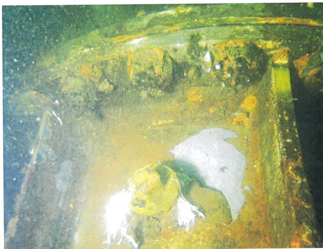
Puntone S4: corrosione sul giunto flangiato
