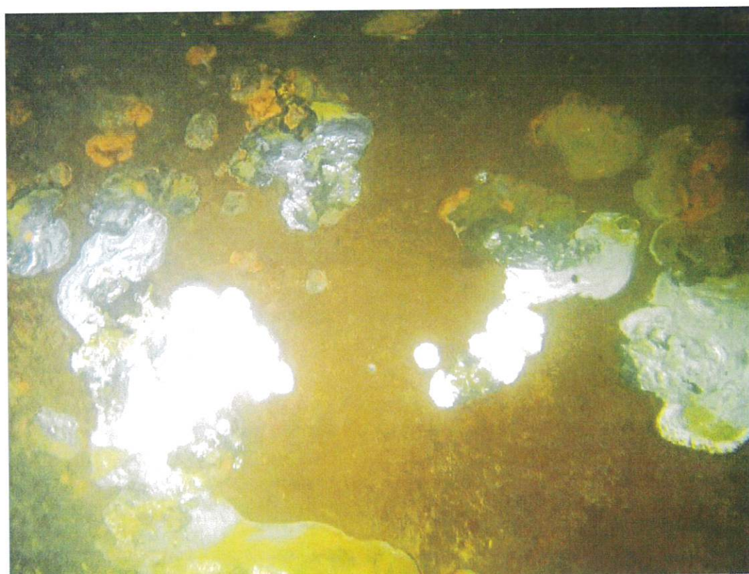
Puntone S1: corrosione sul puntone
