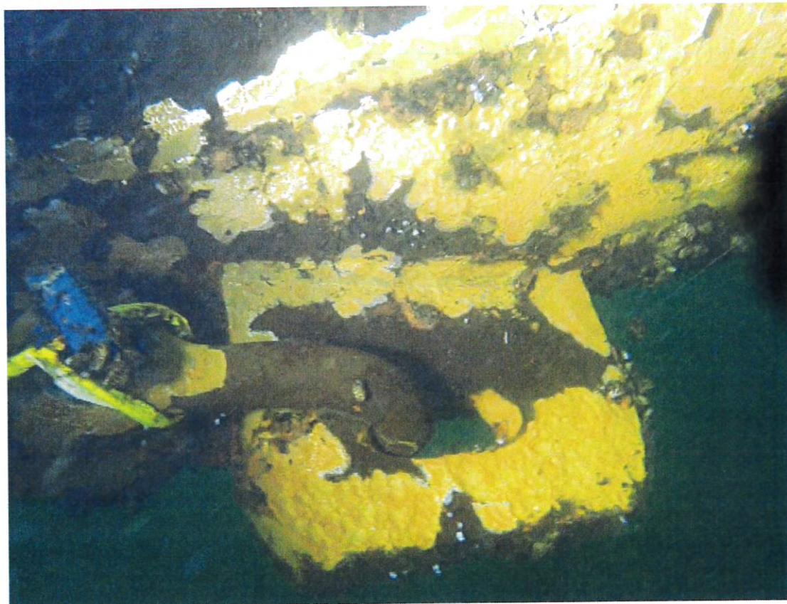
Puntone S2: corrosione sulla piastra ad occhio e sui cordoni di saldatura
