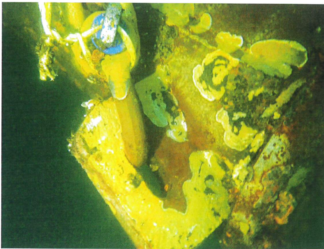
Puntone S1: corrosione sulla piastra ad occhio e sui cordoni di saldatura
