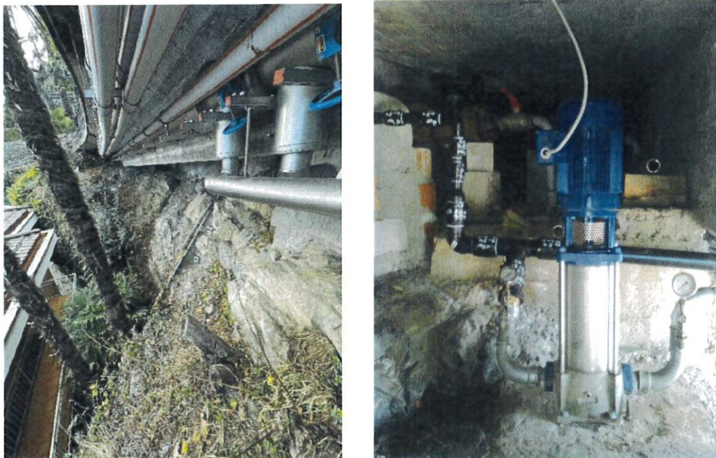
Figura 1: Situazione di ubicazione della pompa attuale
